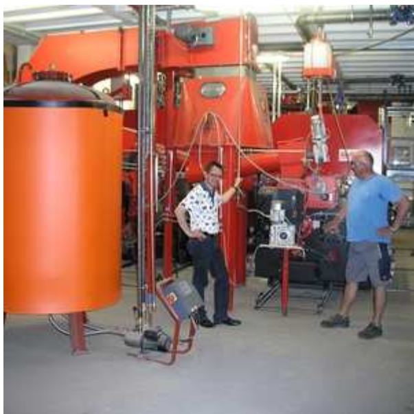
Mitten in der Neustädter Innenstadt steht das „Herz“ der Waso Energie, das Heizwerk. Foto: Dannenberg
